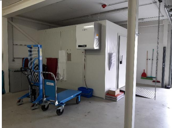
Abbildung 8: Ansicht der Kühlzelle von außen.
