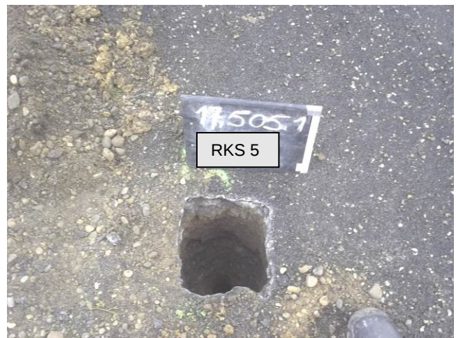
Bild 10: Aufbruch bei RKS 5
