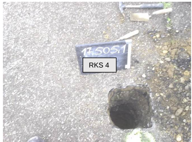
Bild 8: Aufbruch bei RKS 4
