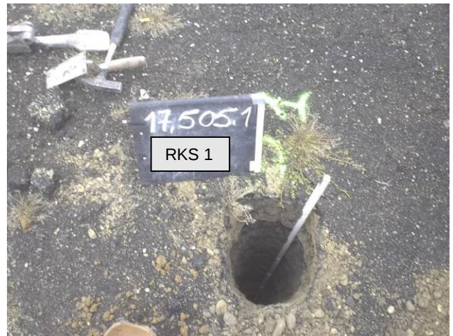
Bild 2: Aufbruch bei RKS 1
