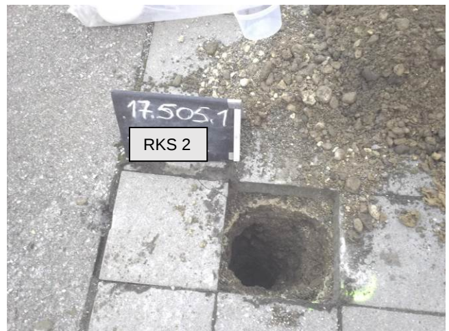
Bild 4: Aufbruch bei RKS 2
