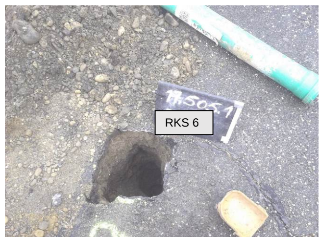
Bild 12: Aufbruch bei RKS 6
