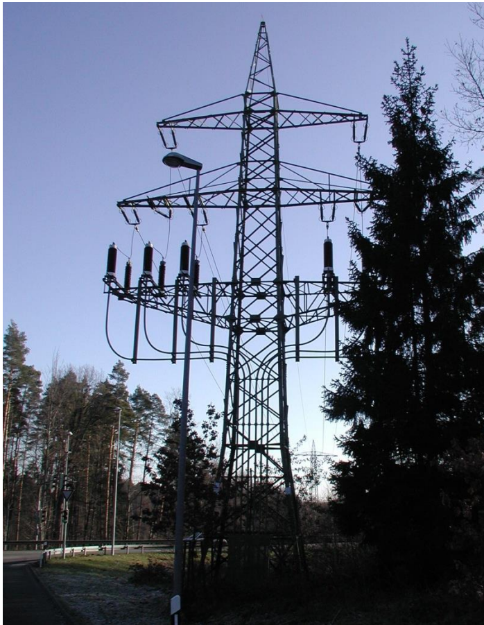
Abbildung 4: Beispiel eines Übergangsmastes mit Kabelendverschlüssen
