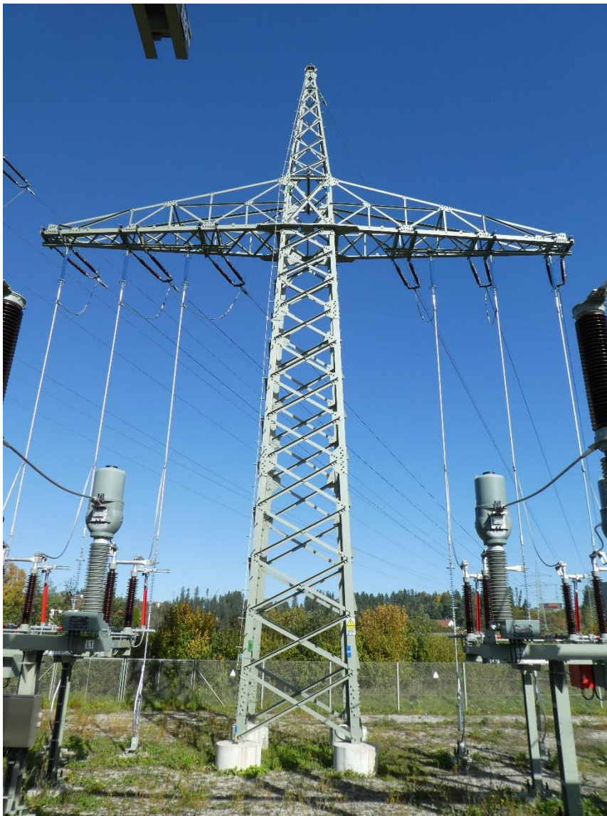
Abbildung 1: Beginn des Planfeststellungsabschnittes am Mast Nr. 1a (Anlage 66001)
